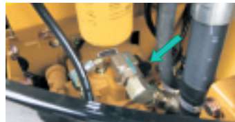
ポンプに設置された 圧力検出タップ
