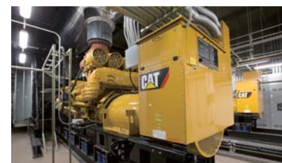
データセンター用バックアップ電源
